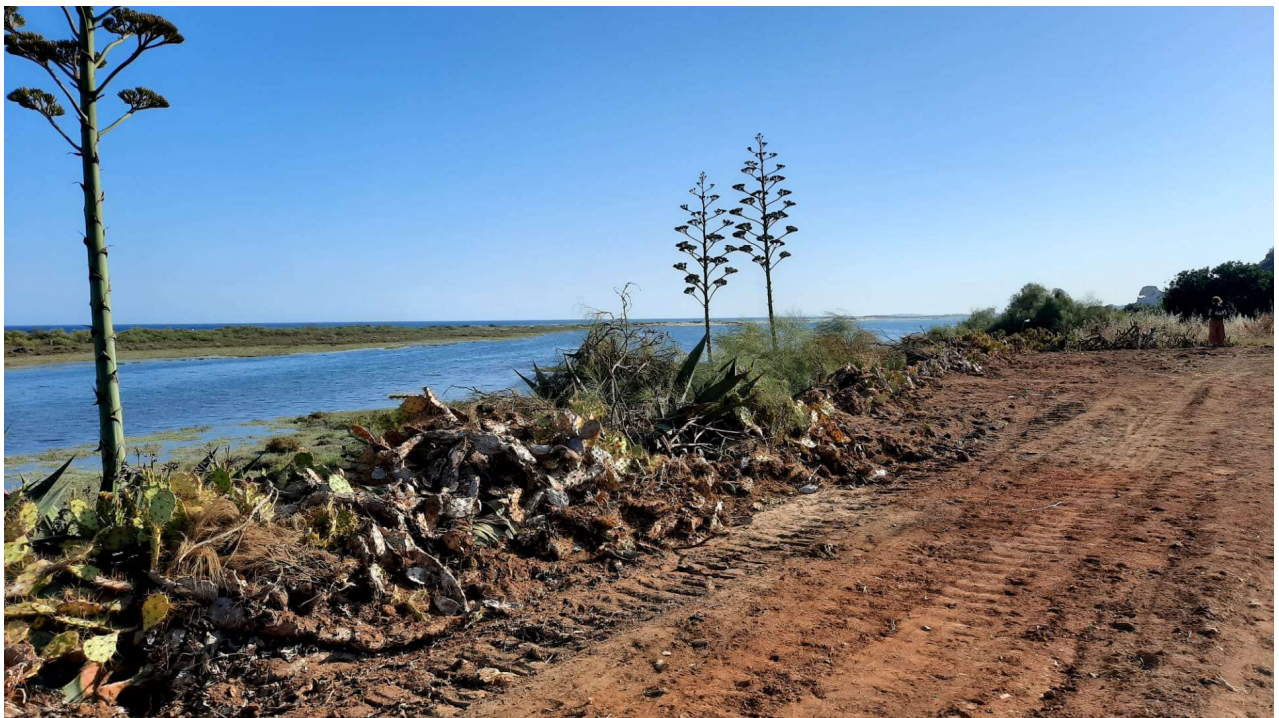
Fotografia do Local da Intervenção - Terraplanagens com destruição da flora autóctone
